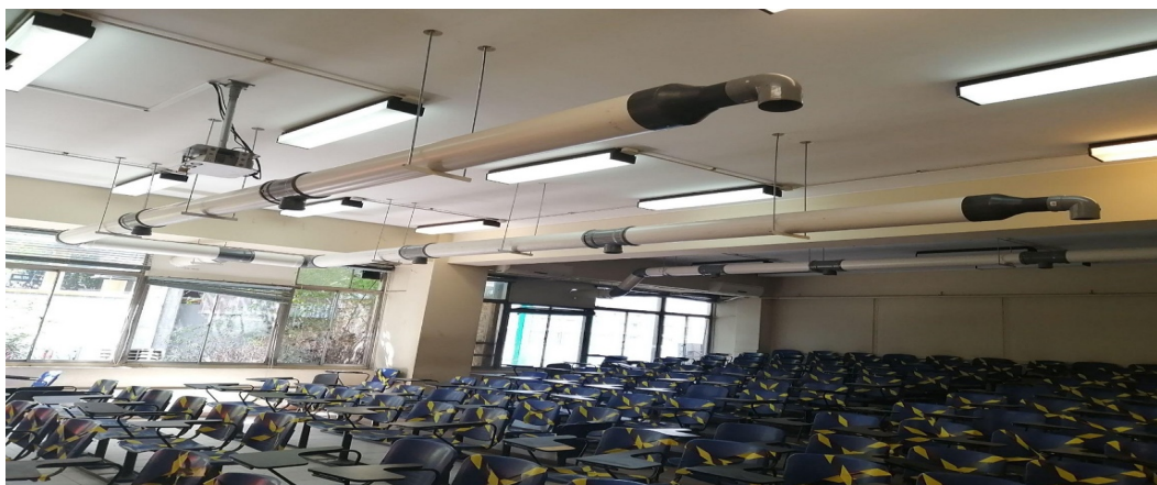
Sistema de ventilación, ductería interior en Salas de Clases 1°Piso Edificio Pabellón G
