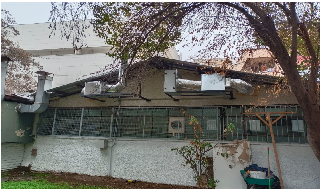
Sistema de ventilación, equipos instalados en Laboratorios Docentes Sector Barracas
